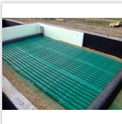
Gruntowy wymiennik ciepła GEOSTRONG – w fundamentach. GWC bezprzeponowy modułowy. Przepływ powietrza turbulentny, wymiana cieplna ze wszystkich stron GWC. Wytrzymałość na nacisk z góry: 460 t/m 2 . Zastosowanie: w wentylacji mechanicznej we współpracy z rekuperatorem w domach jednorodzinnych, wielorodzinnych i przemysle. Możliwość wykonania GWC o każdej wielkości przepływu powietrza. Możliwość samodzielnego montażu.
